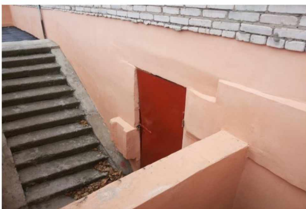
Капитальный ремонт подвала в многоквартирном доме по адресу: Михайловский р-н, п.Горенка, ул.Мира, д. 1
