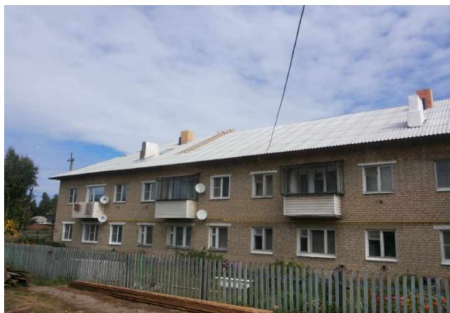
Капитальный ремонт крыши в многоквартирном доме по адресу: г.Сасово, ул. Революции, д. 61а
